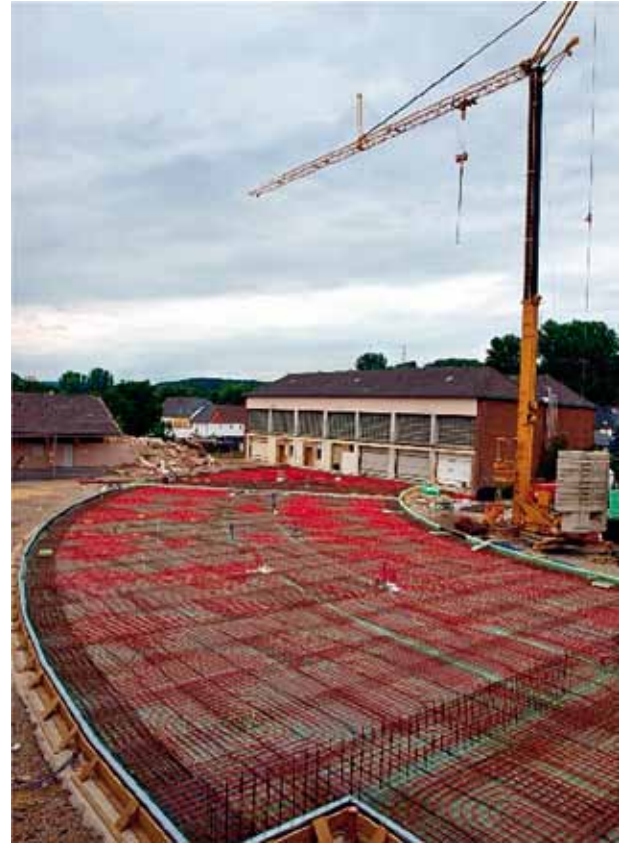
■ In der Bodenplatte werden Rohrleitungen aus Kunststoff mit mehreren Kreisläufen verlegt, in denen das Kühl- bzw. Heizwasser zirkuliert.
