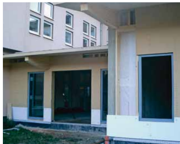
■ Aufbau der Außenwand. Der Sockelbereich des WDVS wird möglichst frühzeitig durch den Verputz geschützt.
